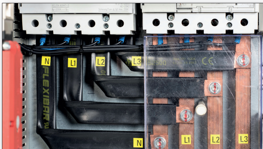
Afbeelding 4. De onderzijde van vermogensautomaten met de contacten naar de PU3Z.
